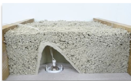
Capot de protection sur spot afin d'éviter les échauffements excessifs
