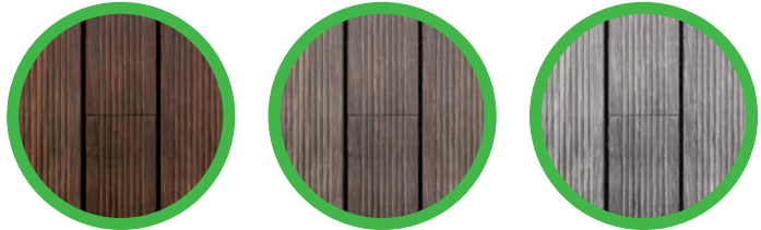
Juste après installation.
